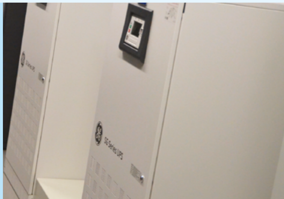
Gruppo UPS: ridondante e collegato con un generatore diesel da 60 kVA, con un'autonomia di 26 ore e con la possibilità di ricarica durante il funzionamento
