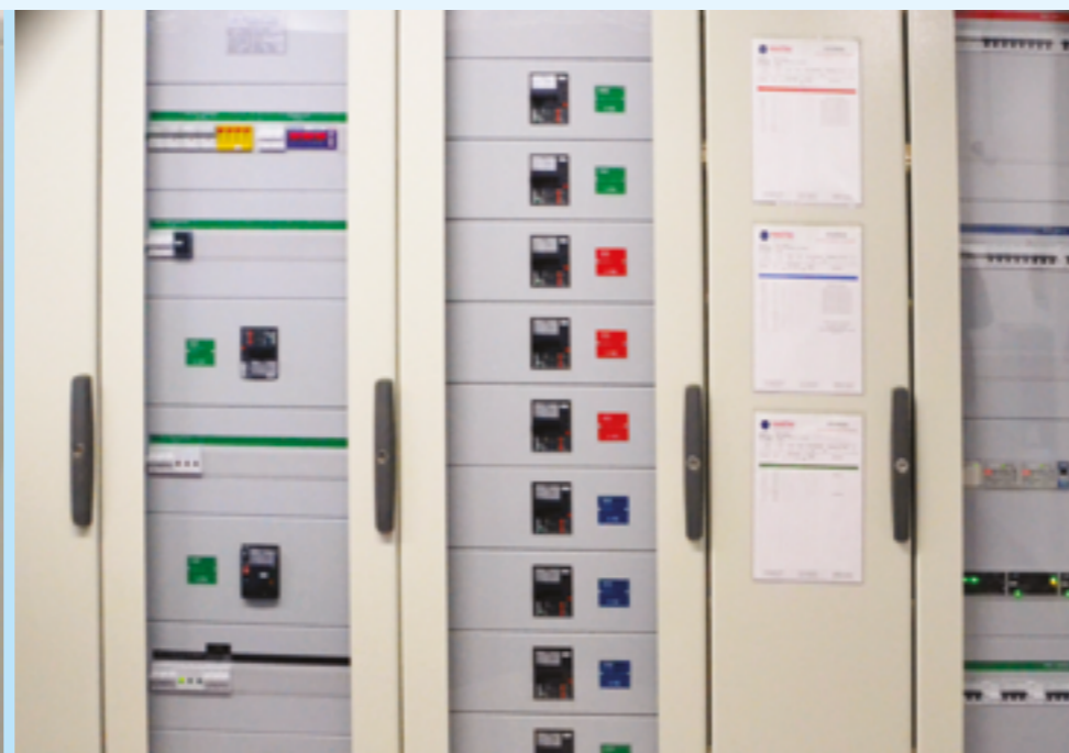
Quadro di controllo dell'alimentazione elettrica
